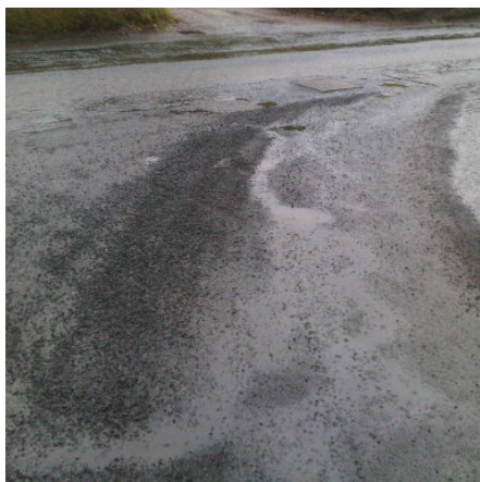
Skader på vei som kan skyldes dårlig blandet asfalt.
