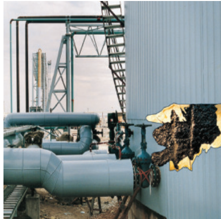
Tankisolasjon som er forurenset av bitumen må skiftes ut.
