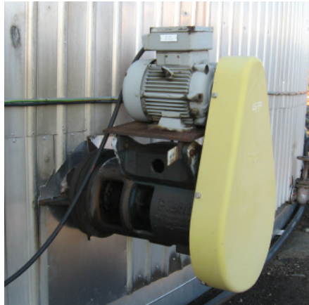
Elektrisk drevet sidemontert omrører på en lagertank for bitumen.
