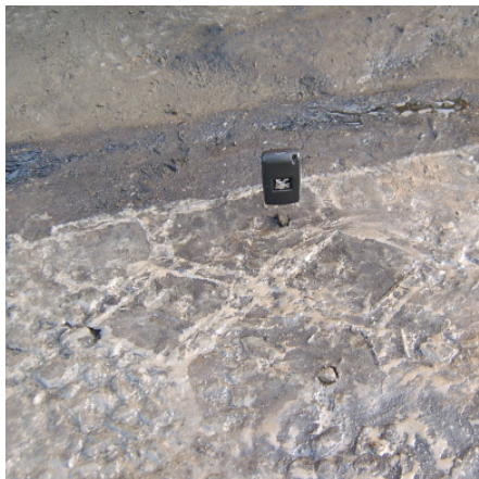
Forringelse og oppløsning av bitumen som følge av drivstoffutslipp.
