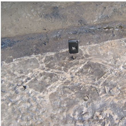
Kütuse lekkimisest põhjustatud asfaldi kahjustumine ja pehmenemine.
